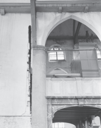
In de jaren 1960 was de kerk toe aan een opknapbeurt. Hier een scheur tussen de toren en het schip op een foto uit 1963. G.Th.
